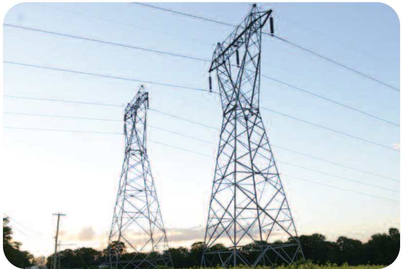
Pylônes de transport de lignes de 345 KV à Keswick, N.-B.
