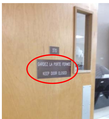
✗ Portes portant l'indication « Gardez la porte fermée » demeurées ouvertes
