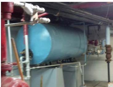
Équipement d'origine de 1967 : récipient sous pression pour l'eau chaude à la fin de sa vie utile
